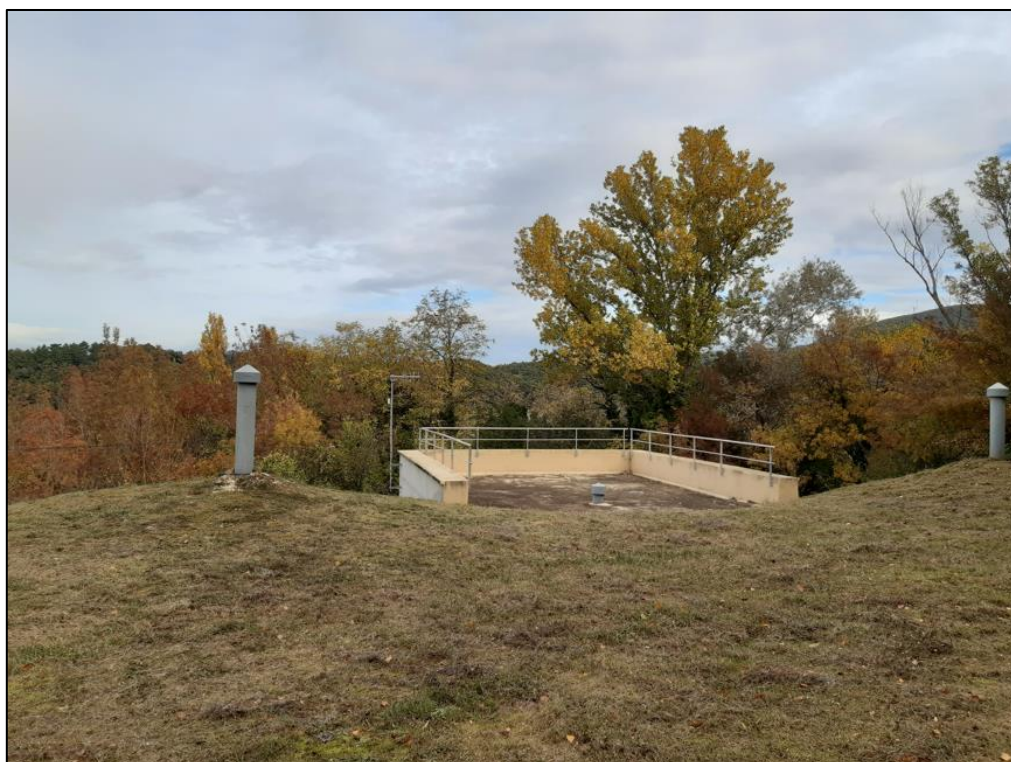
Figure 1 : Réservoir reprise de Chauras (Mirmande)
